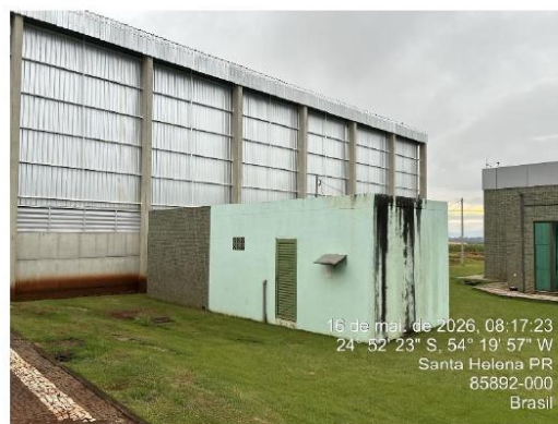
Foto 18 - Casa do compressor
