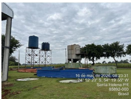
Foto 35- Caixas d' água
